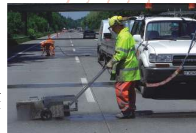
Beim Reinigen der Fugenmulde kommt unser speziell entwickelter Jet-Roboter zum Einsatz. Er ermöglicht das Entfernen alter Fugendichtungsmassen.
