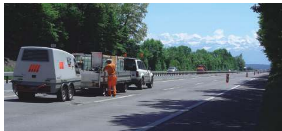
Die Instandsetzung erfolgt kontinuierlich. Wir legen grossen Wert auf eine perfekte Ausführung aller Arbeiten und sorgen jederzeit dafür, dass der Verkehrsfluss möglichst störungsfrei aufrecht erhalten wird.
