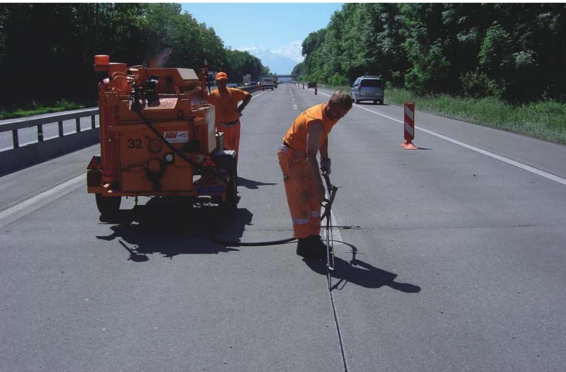
Die kontinuierliche Schulung unserer Mitarbeiter stellt die fachgerechte Verarbeitung sicher. Rapporte dokumentieren umfassend unsere Leistungen im Rahmen des Qualitätsmanagements nach ISO 9001. Umfangreiche Prüfungen an der EMPA bescheinigen die Funktionstüchtigkeit der eingesetzten Materialien.
