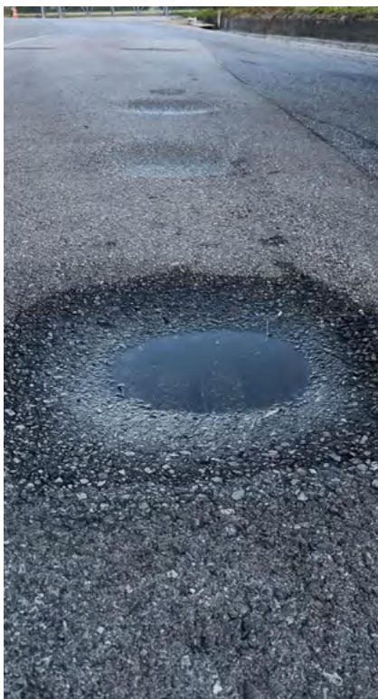
Schäden bei der Anlieferungsrampe
