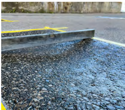
LKW-Verdrückung im Asphalt
